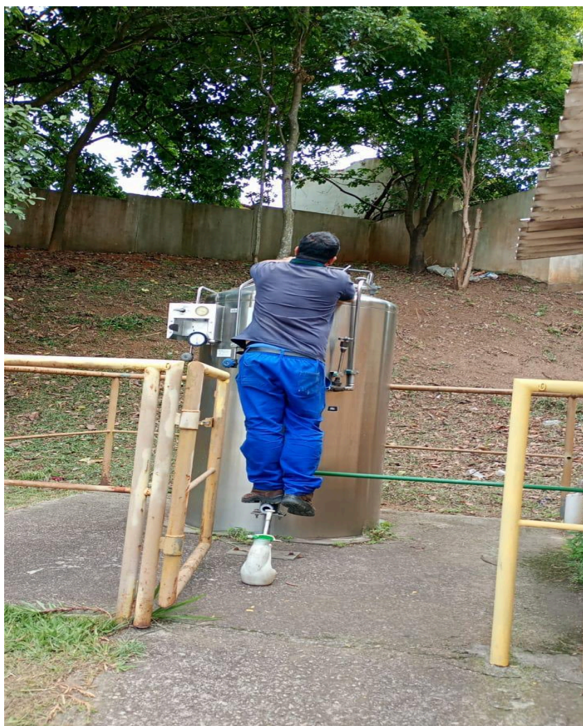
Manutenção - Tanque de Oxigênio
