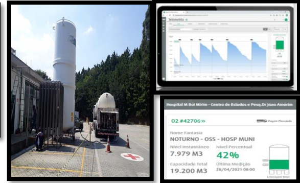
Novo Tanque de O2 + Telemetria
