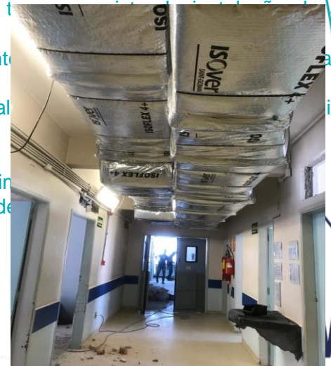
Foto CO com as tubulações do ar condicionado central 07/04/2020
