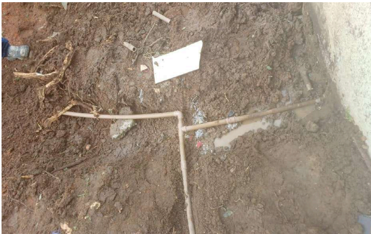
Ligação dos canos água da rua após queda da árvore
