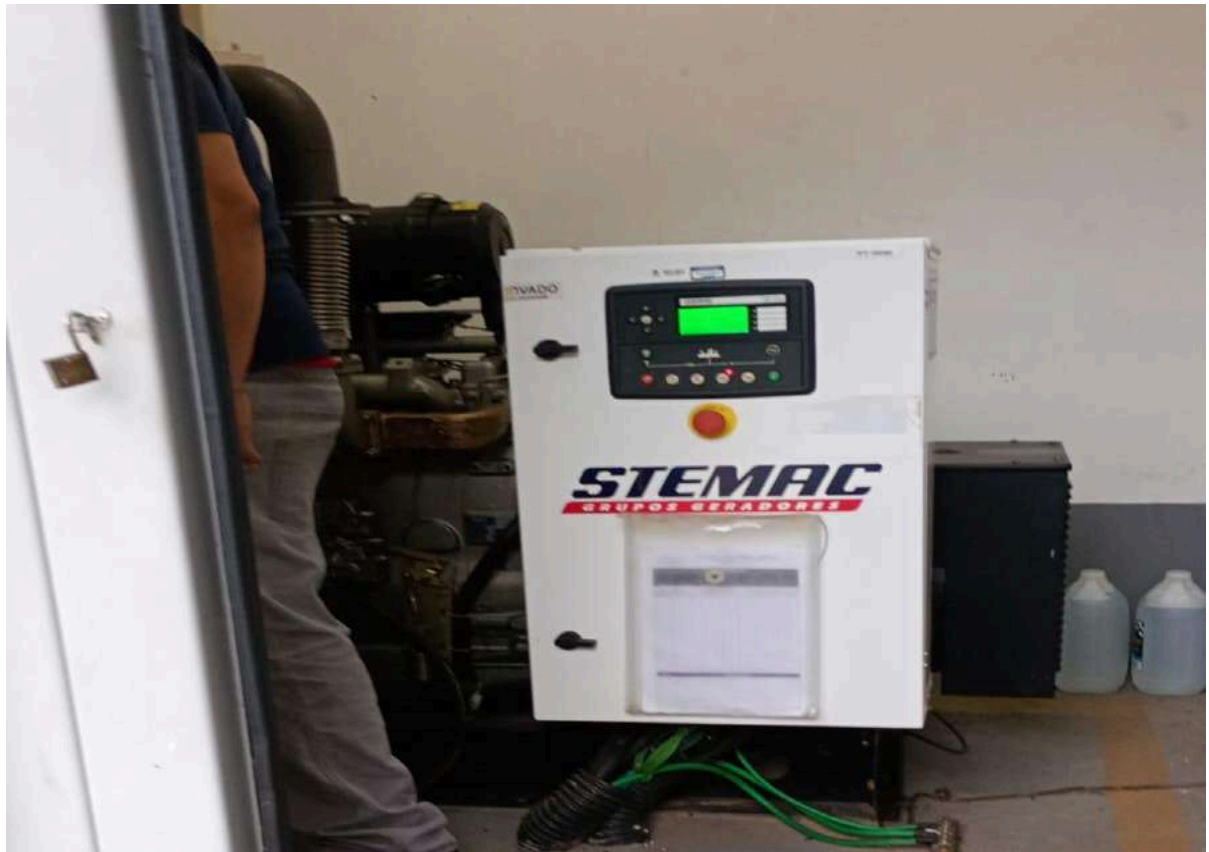
Preventiva de Gerador
