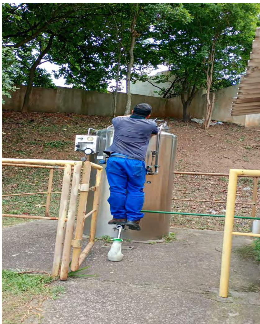
Manutenção - Tanque de Oxigênio
