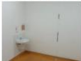
Danos causados por divisão com divisórias navais no 1º consultório lado direito da entrada do ambulatório.
