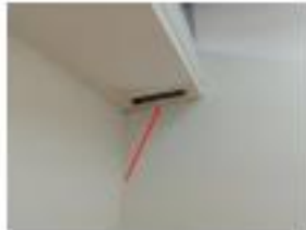
Buracos em Forros de Gesso.
