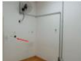
Infraestruturas externa para cabos de rede e elétrica que deverá ser embutido, também danos na parede em Drywall condorne seta na imagem.
