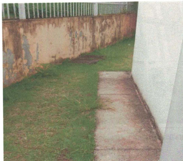
Figura 06 - Muros com pintura degradada
