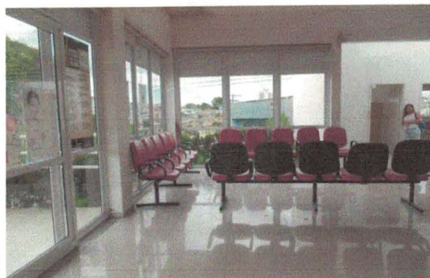
Figura 08 – Recepção com Infiltração
