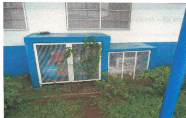
Figura 04 – Abrigo do Compressor
