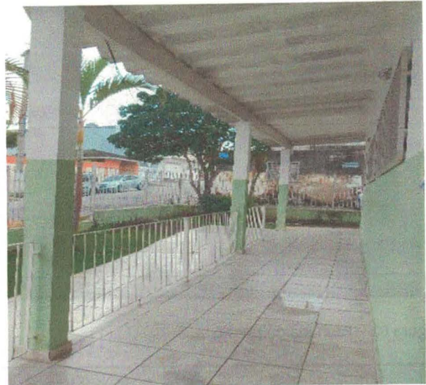
Figura 06 – Infiltração Varand de Entrada
