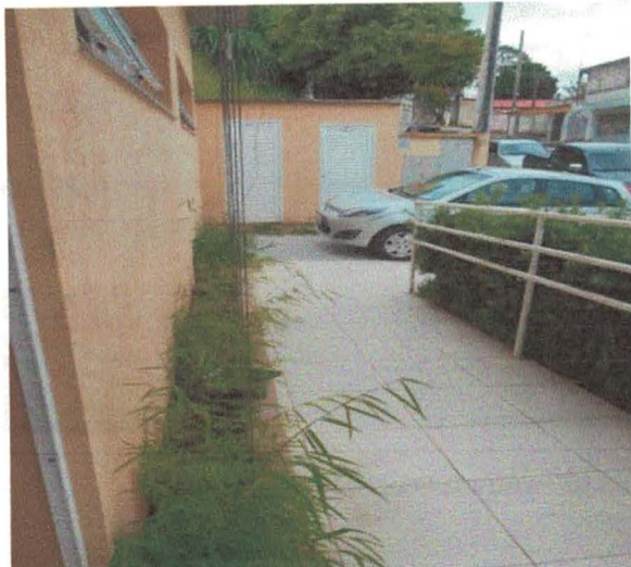
Figura 05 – Rampa de acessibilidade sem piso podotátil
