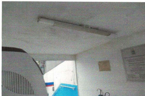
Figura 09 – Infiltração no Teto
