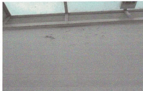
Figura 31 – Infiltração Telhado de Vidro do Corredor
