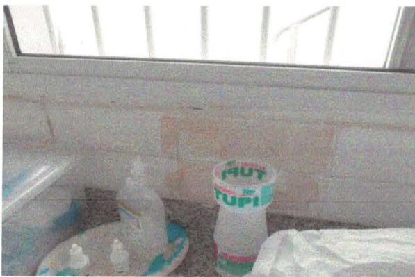
Figura 22 – Infiltração Sala de Medicação
