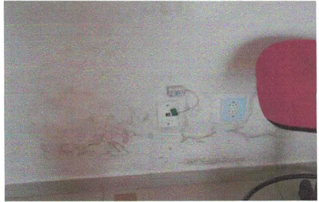
Figura 18 - Parede consultório com infiltrações
