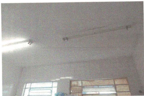
Figura 13 – falta de luminárias
