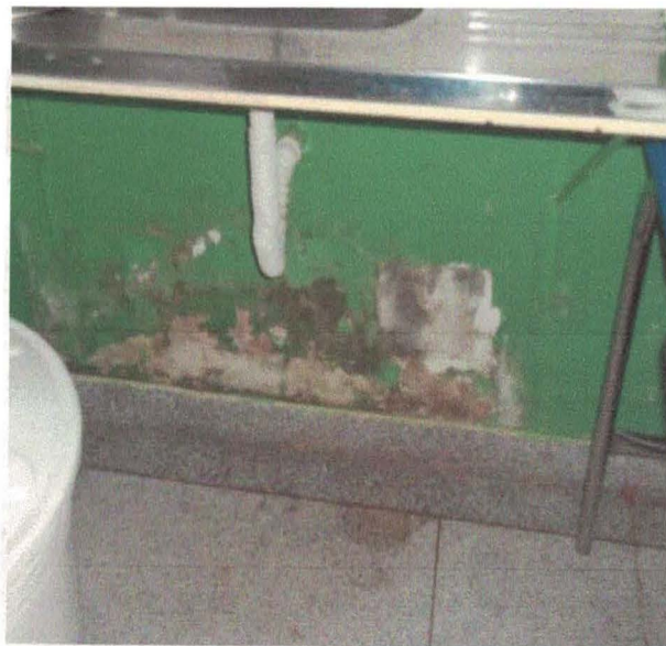
Figura 16 – Infiltração sala de Medicação
