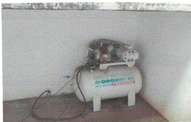
Figura 33 – Abrigo do Compressor sem Porta
