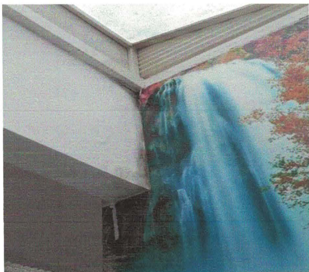
Figura 32 – Grave Infiltração Viga do Corredor de Acesso aos Consultórios
