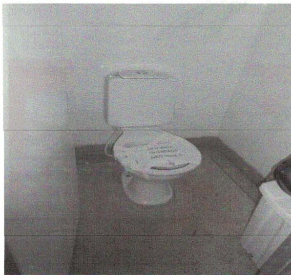
Figura 27 – Vaso Sanitário Interditado
