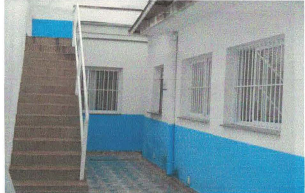
Figura 02 – Corrimão para Acesso da Sala do ACS Fora de Padrão
