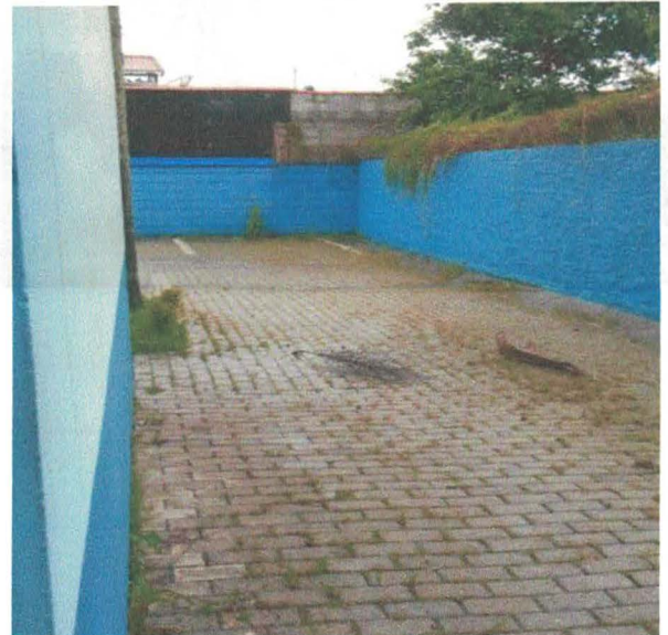
Figura 08 – Area Externa Necessita Cortar Mato
