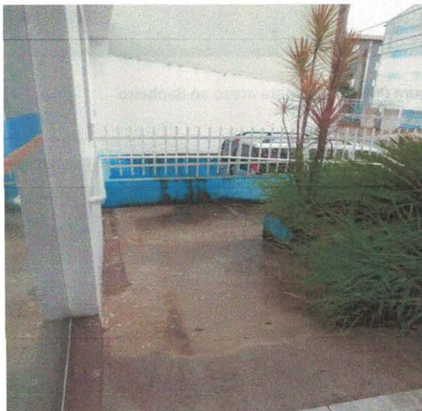
Figura 03 – Rampa de acessibilidade Fora de Padrão
