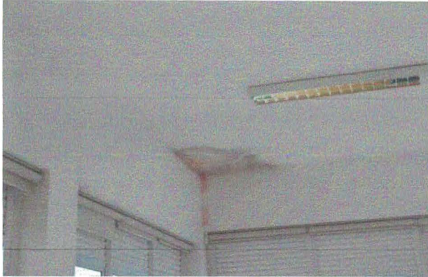
Figura 09 – Paredes com Infiltração
