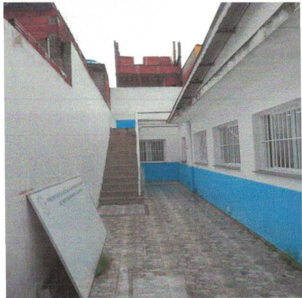
Figura 04 – calha de descida de Aguas Pluviais Danificada
