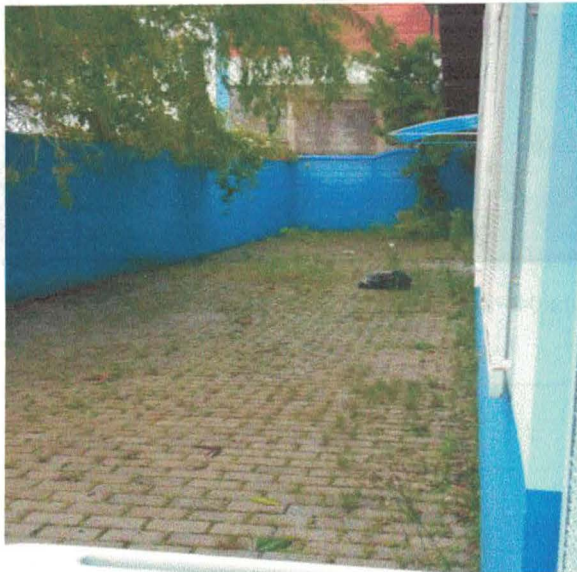
Figura 07 – Area Externa Necessita Cortar Mato
