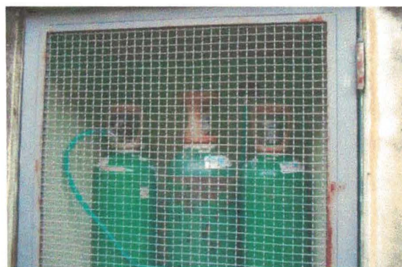
Figura 20 – Abrigo de cilindros inadequado.
