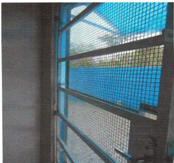
Figura 09 – Porta de Acesso com Vidro Quebrado
