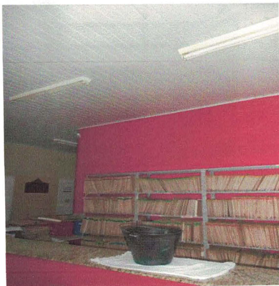
Figura 12 – Vazamento na Recepção
