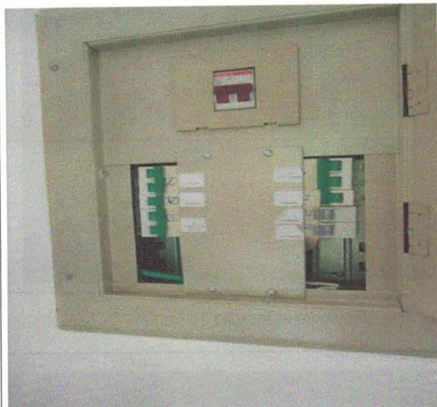
Figura 13 – Quadro Elétrico de Iluminação
