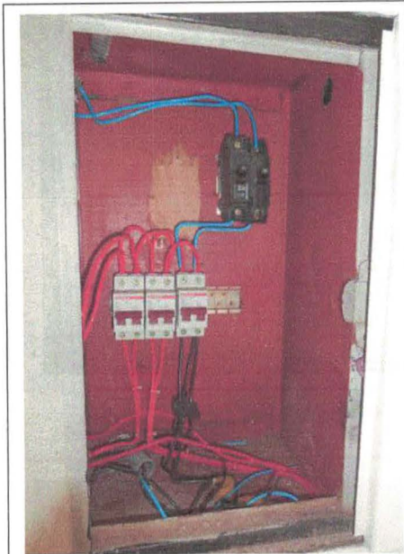
Figura 13 – Quadro Elétrico fora de Padrão
