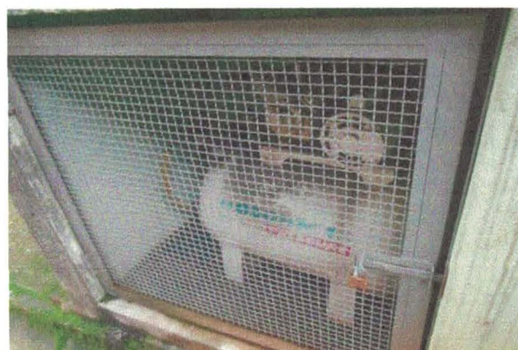
Figura 19 – Abrigo do compressor inadequado
