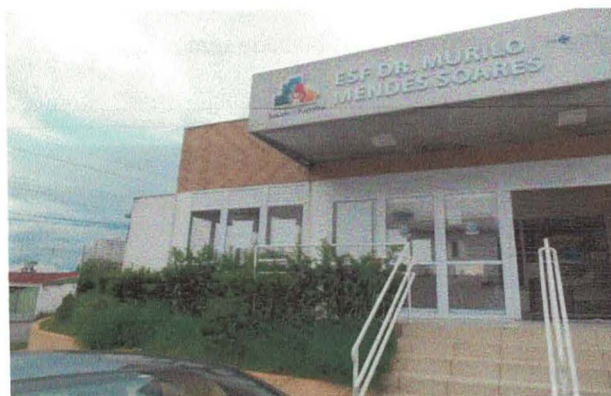
Figura 04 – Corrimão fora de Norma
