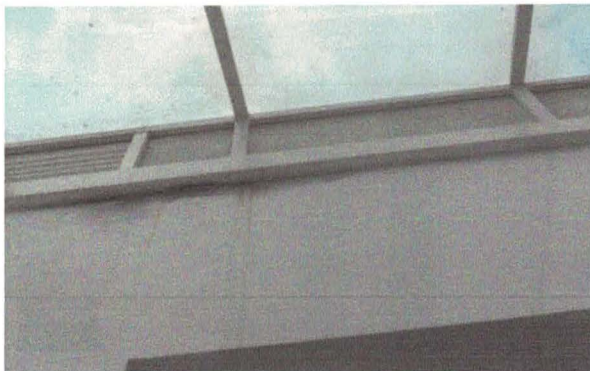
Figura 30 – Estrutura do Telhado do Corredor com Corrosão
