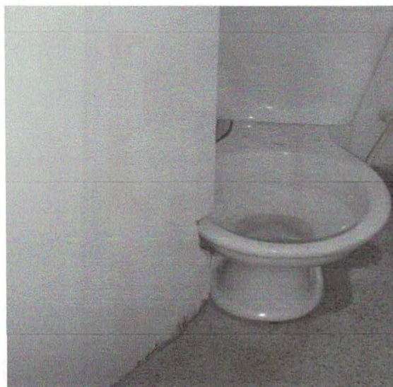
Figura 28 – Porta Inadequada no Box do Banheiro
