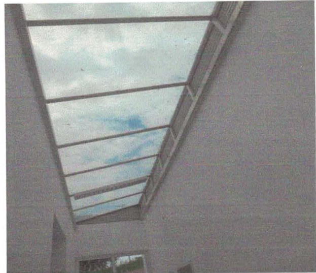
Figura 29 – Corredor de Acesso as Consultórios com Infiltrações
