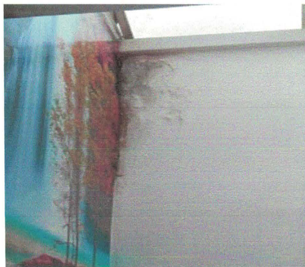
Figura 33 – Grave Infiltração Viga do Corredor de Acesso aos Consultórios
