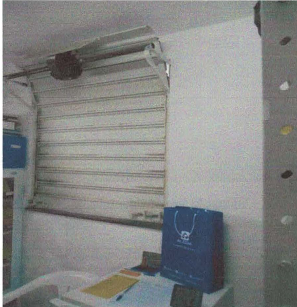
Figura 20 – Porta da Dispensação da Farmacia Danificada
