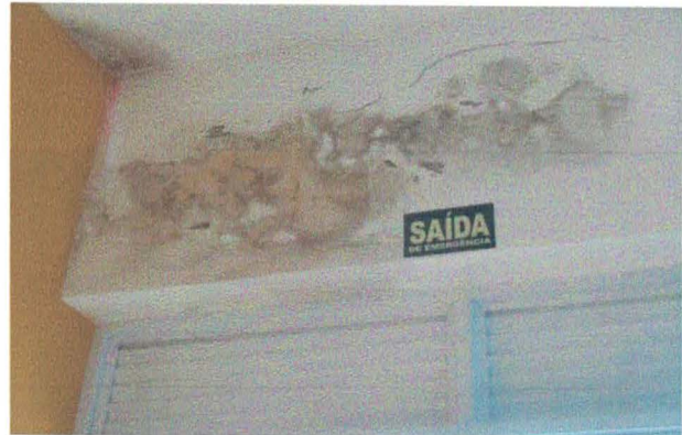
Figura 10 – Vigas com Infiltração
