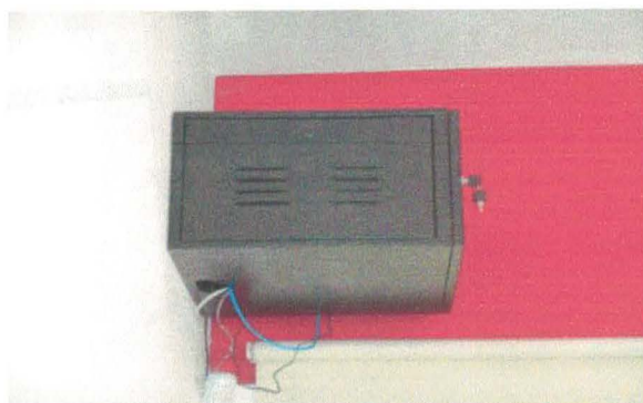
Figura 15 – Rack com Fiação Exposta
