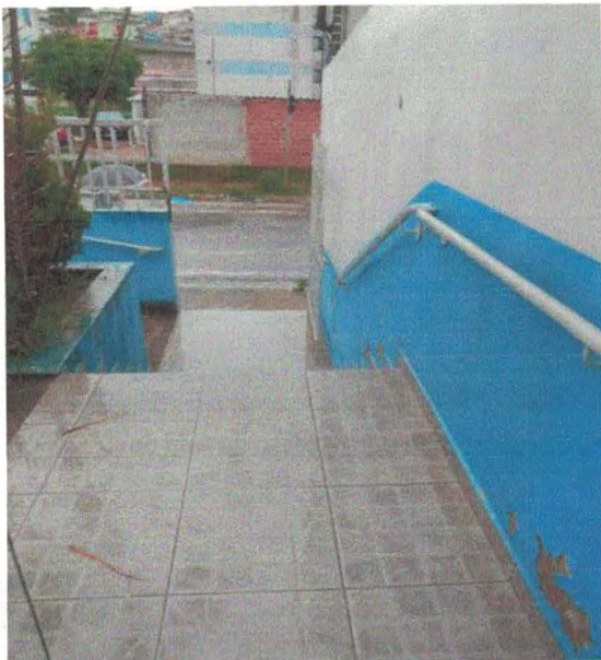
Figura 05 – Falta de Piso Podo Tatil
